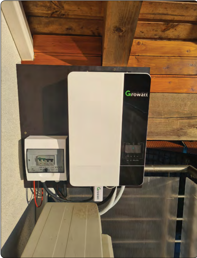
Montiran razsmernik in omarica z DC odklopnikom ter varovalkama. Vir: avtor
