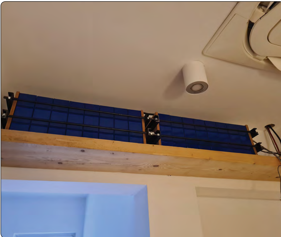
16 celic EVE280K s pripadajočo elektroniko nad preklado. Vir: avtor
